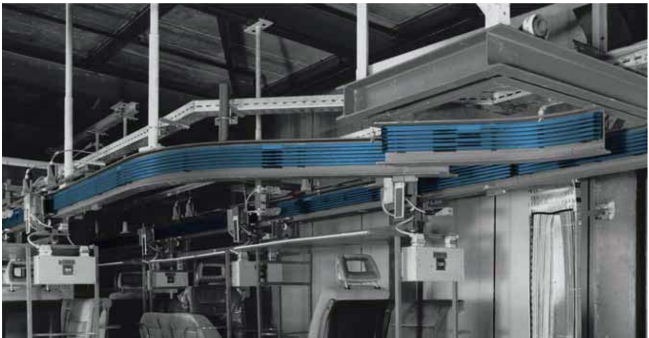
Isolierte Stromschiene U 15, 6-polig an einer Elektro-Hängebahn mit Schiebeweichen in einer Automobilfabrik.
