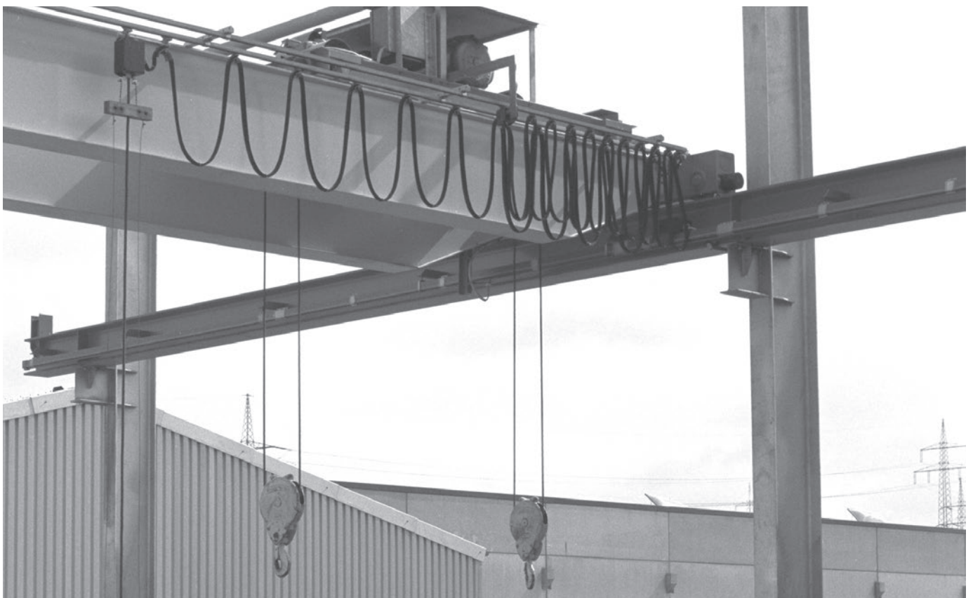
Leitungswagenanlage für Die Katzfahrt an einem Aussenkran
