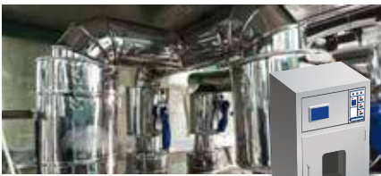
Räume zur Warm-/Kaltlagerung
